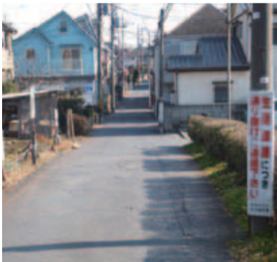
道路の傷みが見られる私道
