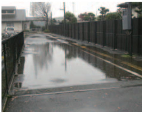
水はけの改善要望をされた中原・本多集会所
