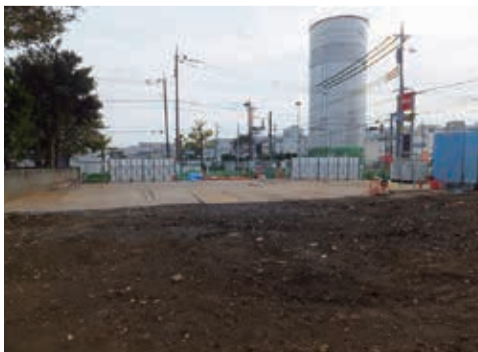
■整備が進む東一丁目の路線バス折返し場(旧野火止浄水場高架水槽跡地)
