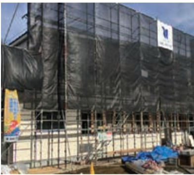
平成29年度に開所予定の(仮称)野火止四丁目保育園(建築工事中)
