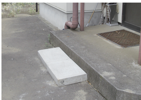
■段差の解消を図った野寺三丁目集会所の玄関上がり口
