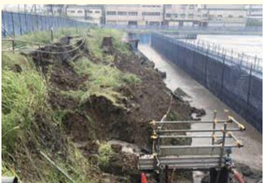
台風19号による調整池の被害の様子
