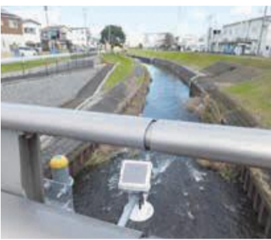
黒目川千代田橋に設置されている危機管理型水位計
