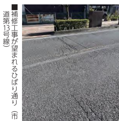
■補修工事が望まれるひばり通り(市道第13号線)
