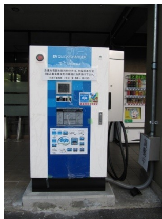
市役所本庁舎前に設置した急速充電施設
